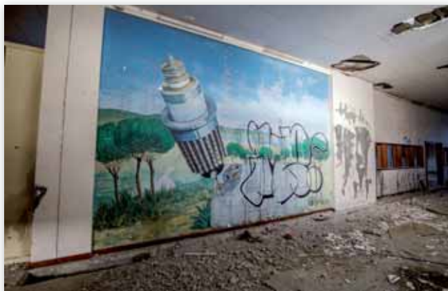
Les instal·lacions en estat ruïnós
